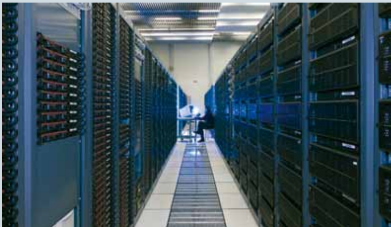
Veduta di una parte della sala server del CERN.
